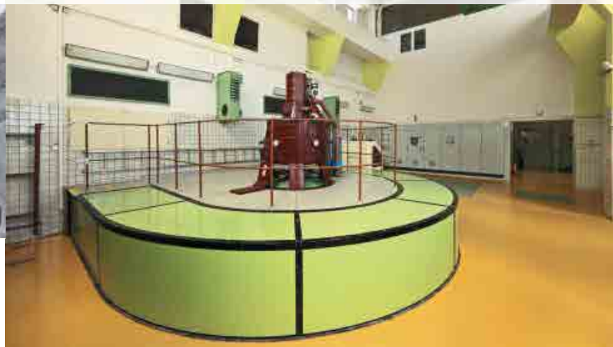
Elektrárna Lipno II vyrábí proud v tzv. průtočném režimu, tj. nepřetržitě.
